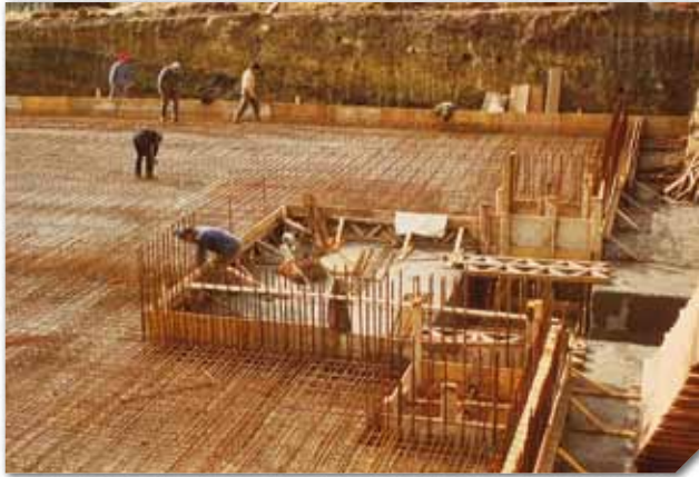
Bauphase des Wasserbehälters auf dem Wangertsberg Phase de construction du réservoir au Wangertsberg
