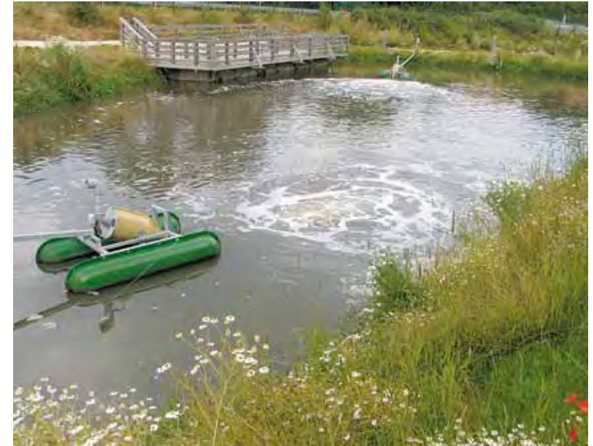
Durch die Belüftung wird der Sauerstoffgehalt des Gewässers erhöht und somit die natürliche Selbstreinigungskraft gefördert.
