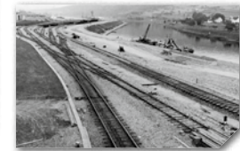
Die Rangier- und Zubringergleise zur Zeit des Hafensbaus La voie ferrée lors de la construction du port
